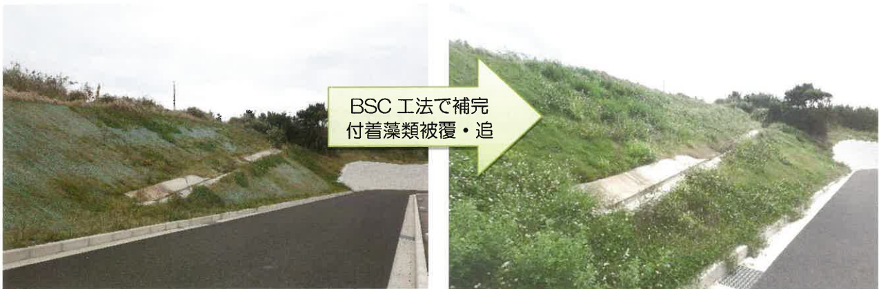
浸食で褐色の基盤が露出・肥料分流失
